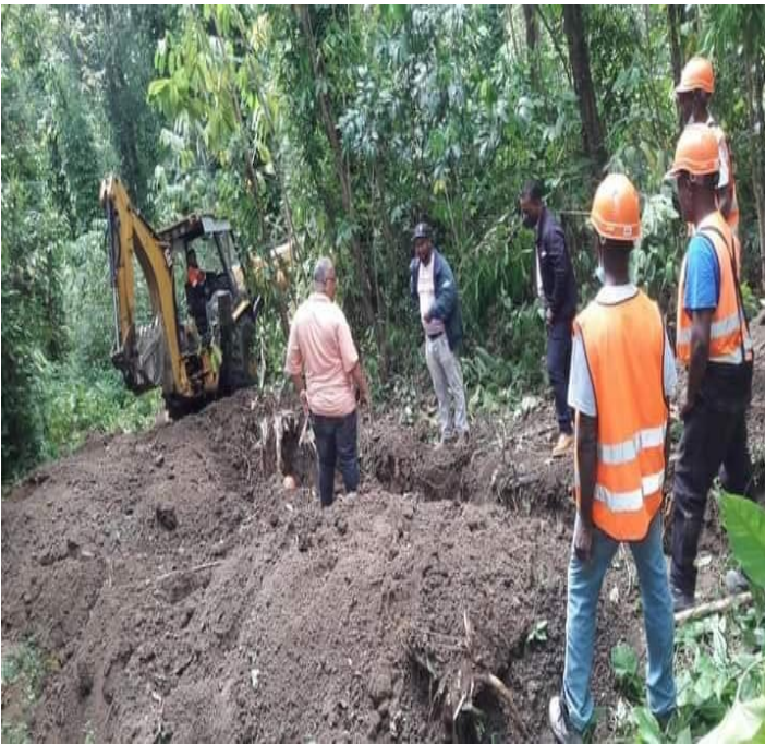
Inicio de los trabajos de conexión del Acueducto de Salcedo con Cayetano Germosén, realizado por un equipo de ingenieros y técnicos de CORAAMOCA, gestionado por el Alcalde Mario Emilio Rodríguez en procura de solucionar el servicio de agua.
