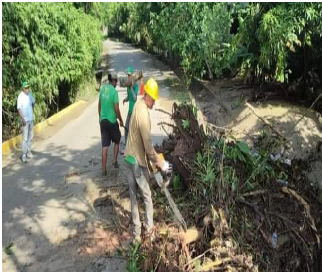
Limpieza y acondicionamiento en el puente del Río Reparadero en la comunidad de Hato Viejo Adentro, afectado por el Huracán Fiona.
